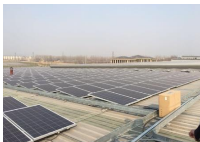
华中天力光伏项目
