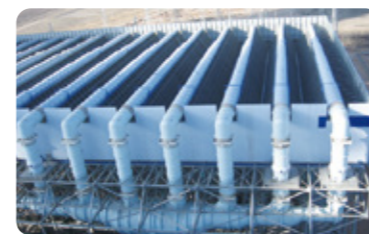
宁夏, 大坝, 直接空冷系统
