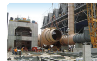
加拿大直接空冷系统联合循环电厂
