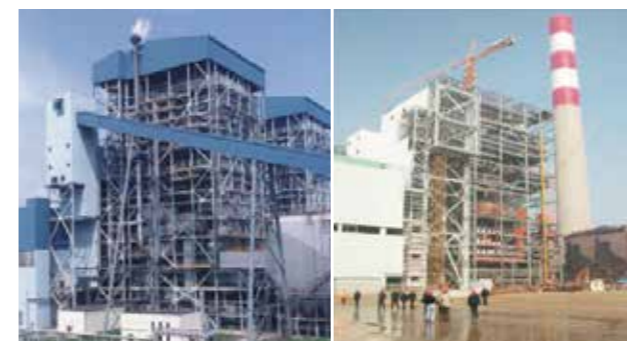
上海电气锅炉
