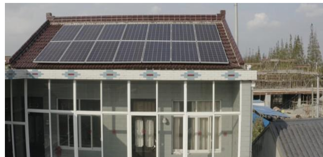
居民楼顶晶硅光伏
