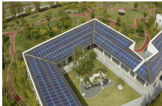
非居民屋顶晶硅光伏
