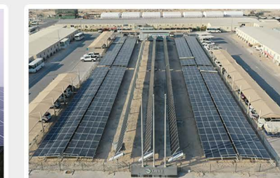
应用项目 巴基斯坦 20MW 光伏电站
