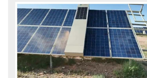
应用项目 甘肃 100MW 地面电站
