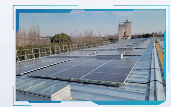
上海振华轴承厂一期0.9366MW光伏项目 Shanghai Zhenhua Bearing Works Co.,Ltd. 0.9366MW PV project I
