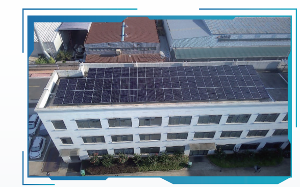
绍兴嵊州250kWp光伏项目 Shaoxing Shengzhou 250KW PV project
